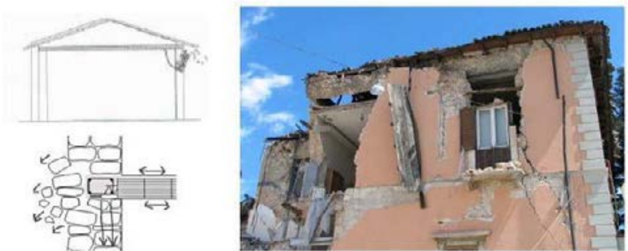
Figura 14 – Abruzzo 2009 – Danneggiamento di muratura in presenza di cordoli in c.a. (fonte: Governare il rischio 2012)
