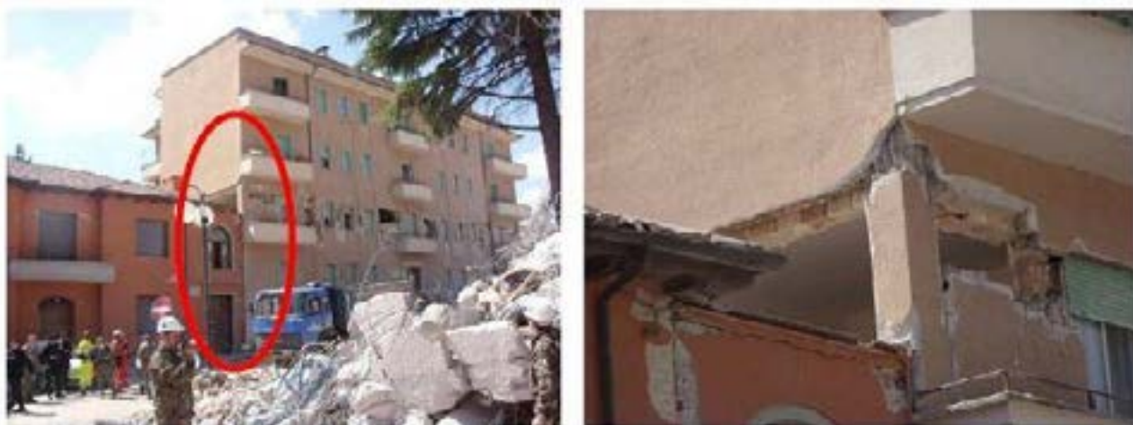
Contiguità di edifici con caratteristiche geometriche e strutturali differenti (fonte Decanini 2009)
